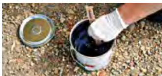
Rør i basen
