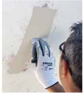
Slip bort eventuelle defekter
